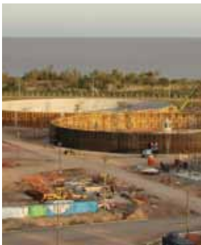
VATTENRESERVOARER OCH VATTENTANKAR
