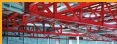
KORROSION OCH BRANDSKYDD
