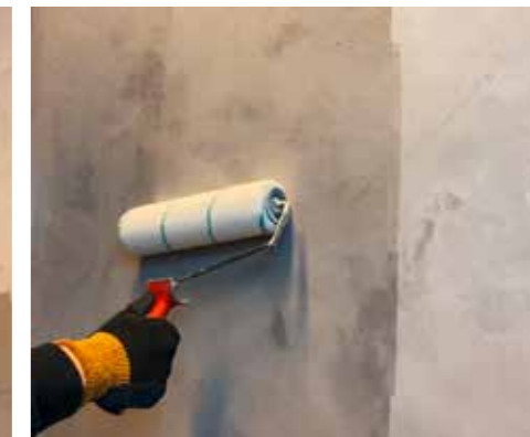
9. Försegla ytan med Sikafloor®-169 PT för en blank yta eller Sikafloor®-304 W för en matt yta. Försegling utförs alltid i minst två lager. Mjukfogar utförs med SCHÖNOX ES Transparent (Blank) eller Casco ClearSeal (Matt) .
